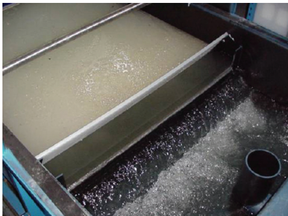
Figura 3: Tanque de flotação de uma estação de tratamento de água mostrando espuma esbranquiçada na parte superior do sistema de fases e água límpida na fase inferior após a flotação. A água purificada é coletada abaixo da espuma. (fonte- http://www.enprotec-usa.com/html/airphotos.html )
